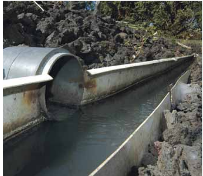
Caudal de agua residual repartido en canales a los filtros
