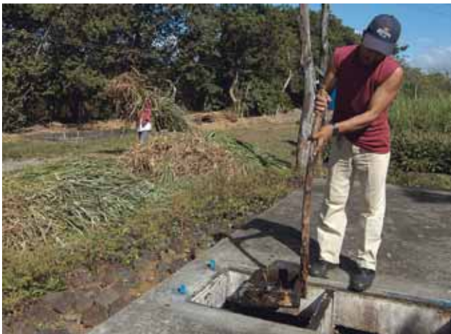
Remoción de nata flotante en cámaras de sedimentación del Tanque Imhoff
