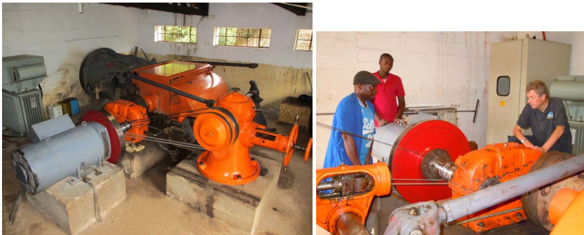
Turbine und Generator im Kraftwerk
