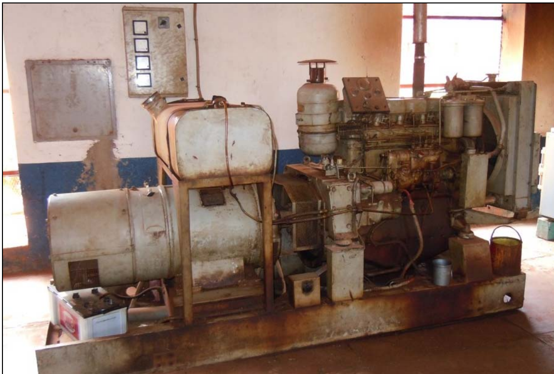
Alter Dieselgenerator (3x230V)
